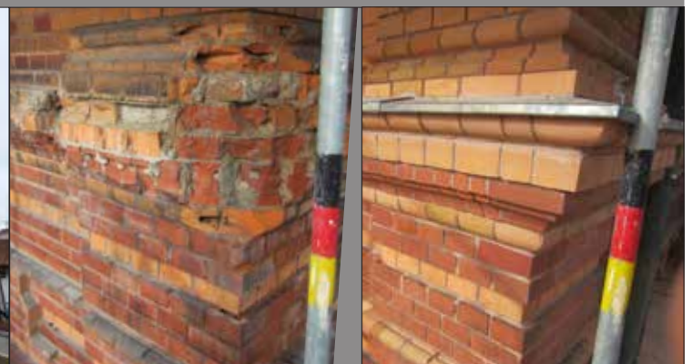
Ziegelgesims vor Sanierung
