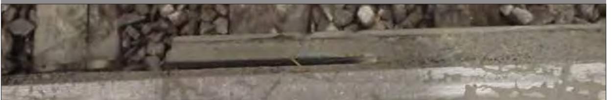
München (D), U-Bahn-Stationen, Bordkanten beschneiden Auftraggeber | Beteiligte: Stadtwerke München | Münchner Verkehrsgesellschaft
