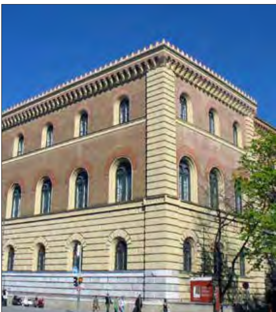
München (D), Staatsbibliothek, 1. Hälfte 19. Jh. Begutachtung, Sicherungen, Teilsanierung der Putzfassade Auftraggeber | Beteiligte: Staatliches Hochbauamt München I
